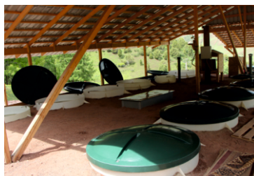
Очистные сооружения этнокомплекса Чункурчак
