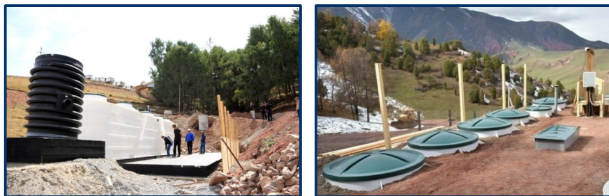
Этнокомплекс Супара. Водоочистное сооружение Сокращение потребления воды на 30% более 20 000 кубометров в год
