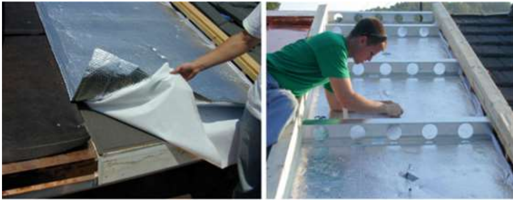
图 23 由 Outlast 生产的建筑屋顶组件包含的细节、反射隔热、子排气空气通道、两个 PCM 绝缘系统
